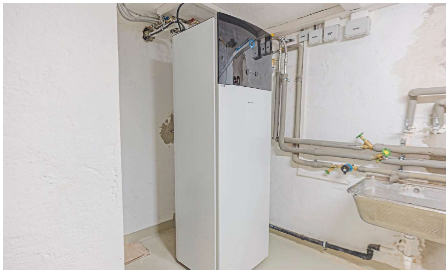
Das Innengerät zeigt nach dem Umbau, wie eine Installation nicht nur funktional, sondern auch optisch überzeugen kann.
