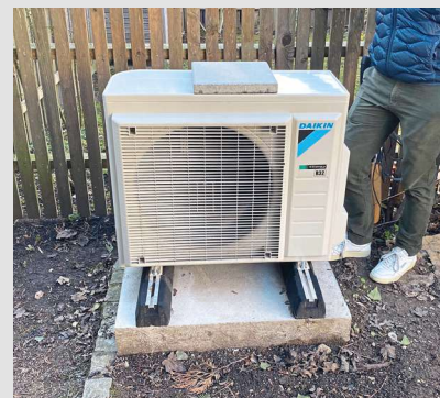
Die Wärmepumpe stand vor dem Umbau auf einem Fundament, auf dem das Kondensat nicht frei ablaufen konnte. Im Winter bildete sich dadurch Eis, das die Funktion der Gummifüße beeinflusste – diese sollten aber eigentlich schalldämmend wirken.
