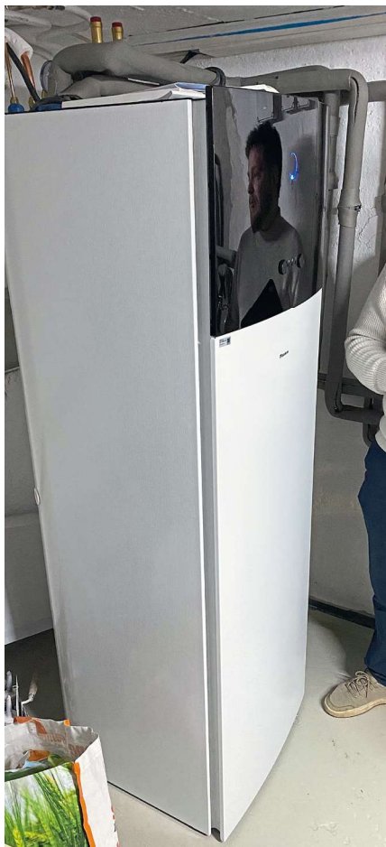
Am Innengerät wurden bei der Erstinstallation die Rohrleitungen nicht gedämmt und die Kältemittelleitung war zudem nicht durchgängig verlegt.
