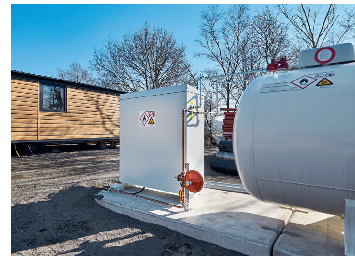
Fünf 2,9-Tonnen-Tanks mit nachgeschaltetem Verdampfer versorgen die insgesamt 106 Tiny Houses zuverlässig mit Flüssiggas.
